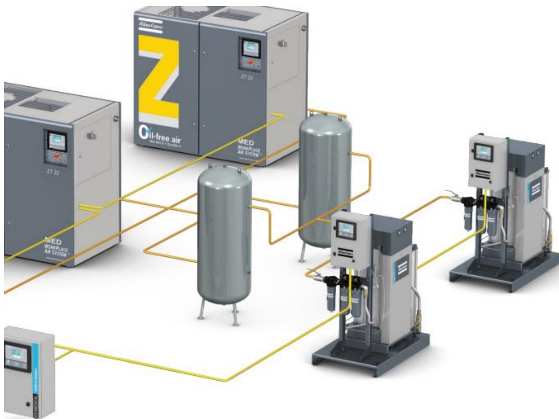
Rys. 1.1. Sprężarkownia: od lewej: sprężarki ( będą 3 szt), 2 zbiorniki i 2 zestawy uzdatniania powietrza medycznego z kontrolą dystrybucji powietrza medycznego do instalacji budynkowej.
