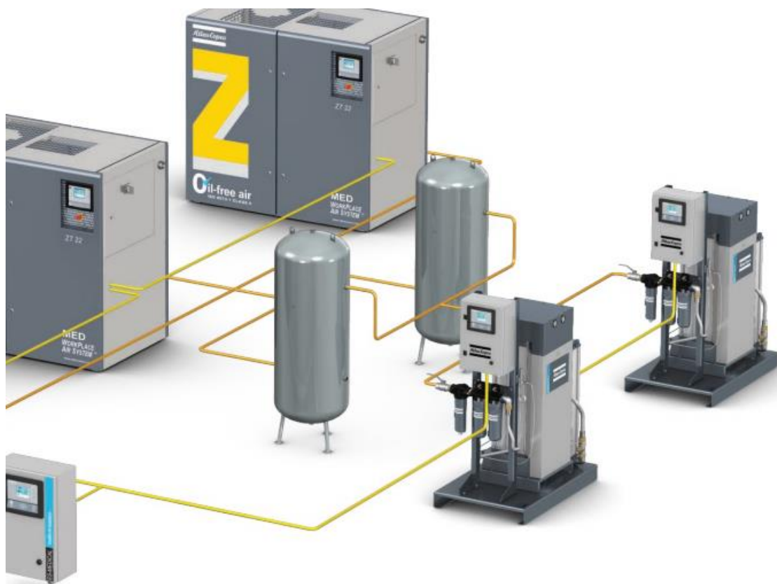
Rys. 1.1. Sprężarkownia: od lewej: sprężarki ( będą 3 szt), 2 zbiorniki i 2 zestawy uzdatniania powietrza medycznego z kontrolą dystrybucji powietrza medycznego do instalacji budynkowej.
